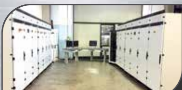
progettazione e realizzazione quadri elettrici di automazione
